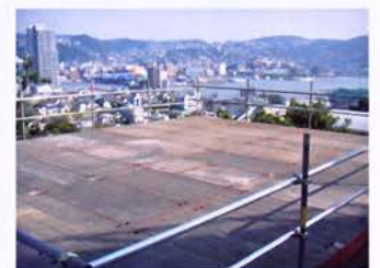
H鋼と覆工板とが固定金具にて一体化し仮設構台が完成！
