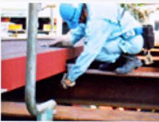
1枚目の覆工板に固定金具を設置し、Aボルトを固定して、Bボルトは仮止めする
